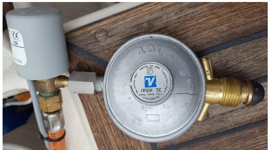
Bild 1. Den deformerade regulatorn med sprucket lock. Till vänster sitter en fjärrstyrd avstängningsventil.
